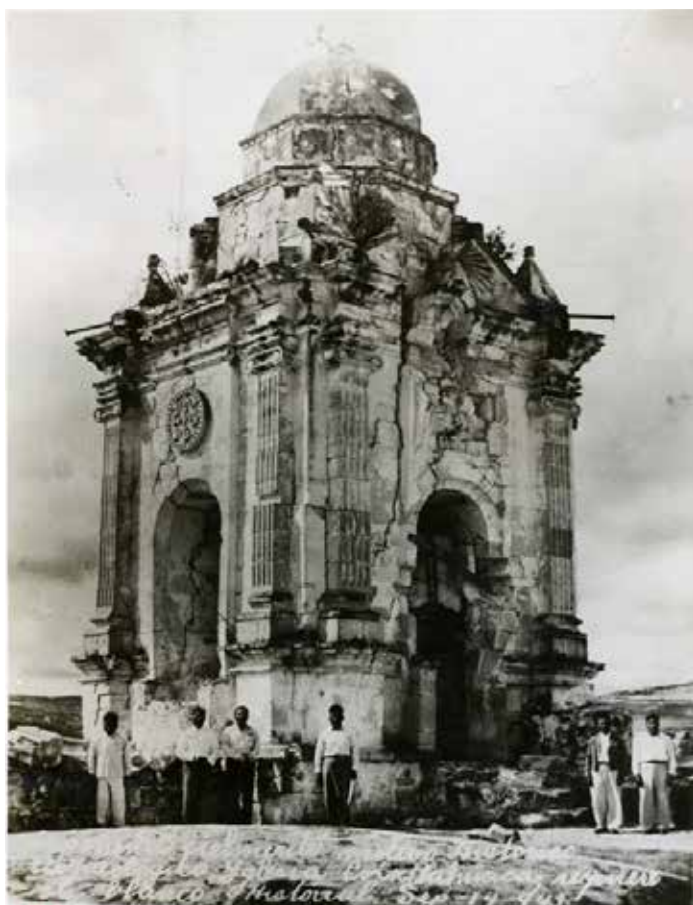
▲ Fig. 4 Estado de la torre tras los terremotos. CLXXVII-100, V0A15TVII-A, CNMH | © INAH, 1949.
