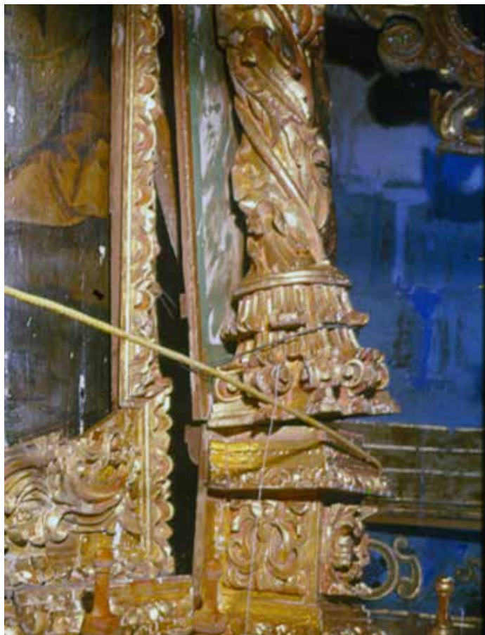
▲ El sismo de septiembre de 1999 provocó que se desprendiera uno de los tensores que aún sostenía el retablo al muro ocasionando mayores daños y aumentando la inestabilidad del mismo. | © INAH, 1999.
