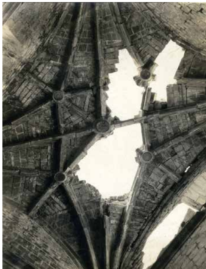
▲ Fig. 3 Estado de la bóveda de la sacristía adyacente a la capilla abierta. sn_folio83. V0A15TVII-B, CNMH | © INAH, 1926.
