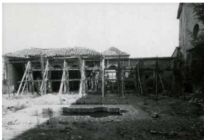
▲ Fig. 43 Vista del Patio de Machuca en obras, la pared y techumbre apuntalada con trancos de madera. | © APAG/ Colección de Fotografías/ F-13010. R-3870
