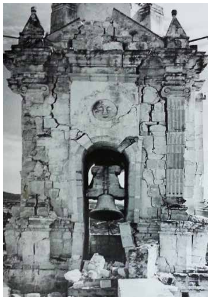
▲ Fig. 26 Torre después del sismo de 1980. (ACNMH. Exp. San Juan Bautista de Coixtlahuaca. Leg. 2. Foto n° 20). | © INAH, 1980.
