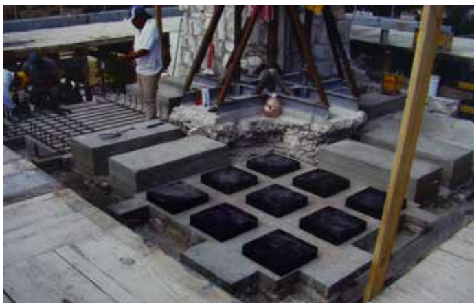
▲ Fig. 42 Estructura antisísmica instalada en la base de la torre. Sobre la plataforma de hormigón se han dispuesto unos dispositivos de neopreno cuya finalidad es controlar la vibración de la torre. Los topes de hormigón armado situados en el centro deben limitar el posible movimiento de la torre en caso de sismo. Imagen tomada de la documentación del proceso de obra en Coixtlahuaca. | © INAH, 2014.
