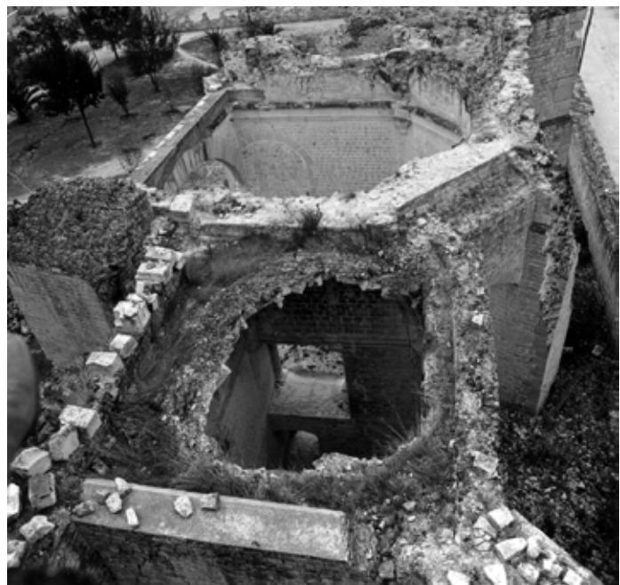
▲Fig. 21 Bóveda destruida de la sacristía adyacente a la capilla abierta. COIXTLAHUACA_11A-2_1964-1969. XXIII-A-6-1. F. Palancares. Fototeca CNCPC | © INAH, 1965.
