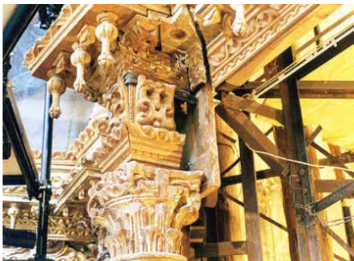
▲ Tensor de hierro colocado en el capitel de las columnas del sexto nivel para anclar el retablo al muro del ábside. Intervención de 1957. | © INAH, 2014.
