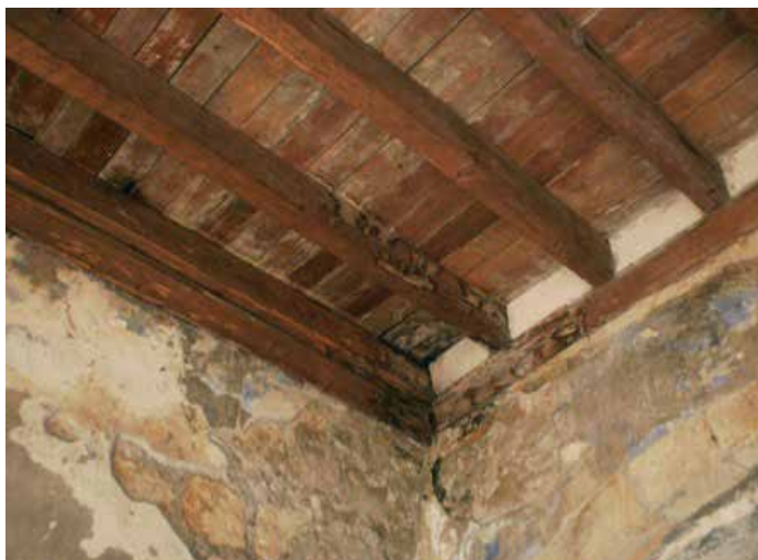
◀ Madera y pintura mural dañada por la orina de los murciélagos, el daño es evidenciado por manchas blancas. Convento de Huaquechula, Puebla | © CNCPC-INAH, 2013
