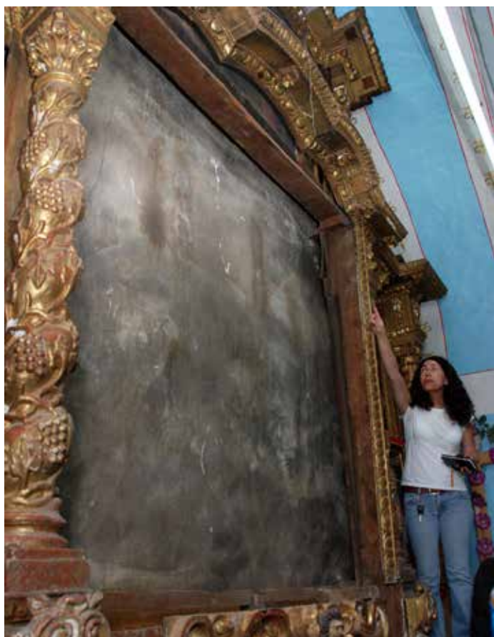
▲ Evaluación de obra en el templo de la Purísima Concepción en Izúcar Matamoros, Puebla | © CNCPC-INAH, 2009
