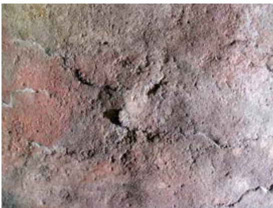
Figura 3. Acercamiento donde se observa la disgregación por escamas y pulverización además de velos blancos por eflorescencia de sales. Puede notarse también la disgregación del aplanado. Imagen: Proyecto de conservación e investigación para las pinturas murales y otros acabados arquitectónicos de la zona arqueológica de Cholula, Puebla, ©CNCPC-INAH.
