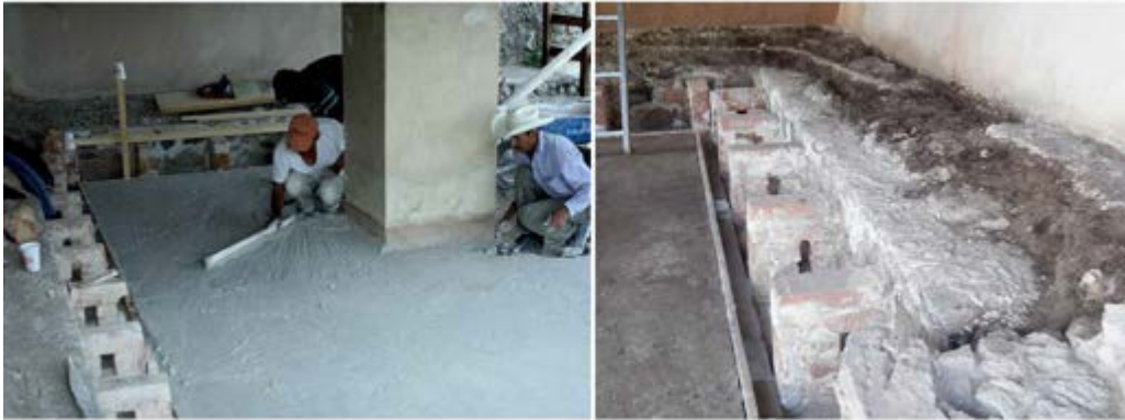
Figura 7. Colocación de piso de sacrificio a base de cal modificando las pendientes. Imagen: Gonzalo Fructuoso, 2015, ©CNCPC-INAH.
