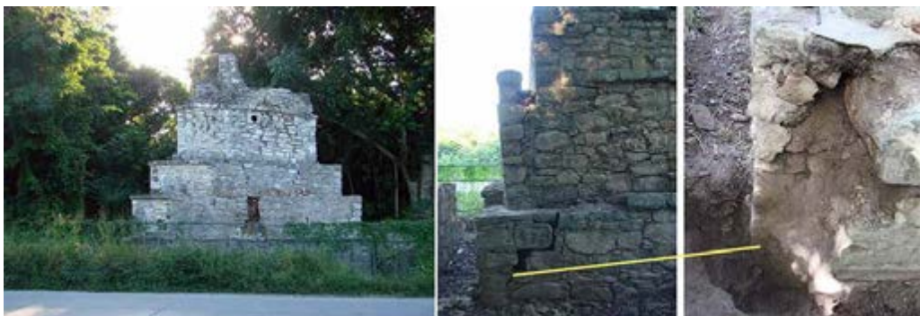
Figura 14. Raíces encontradas en el interior del basamento de la Estructura 12. Al centro del segundo cuerpo de la fachada poniente. Derecha: Esquina sureste del primer cuerpo del basamento. Imagen: Alejandro Martínez (2011: 204-207).
