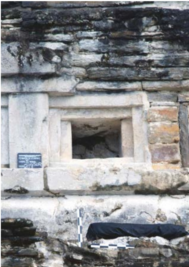
Figura 7. Vista de la cara exterior del nicho donde se aprecia la capa de aplanado. Nicho No. 289, Cuerpo 5, Fachada Sur.
