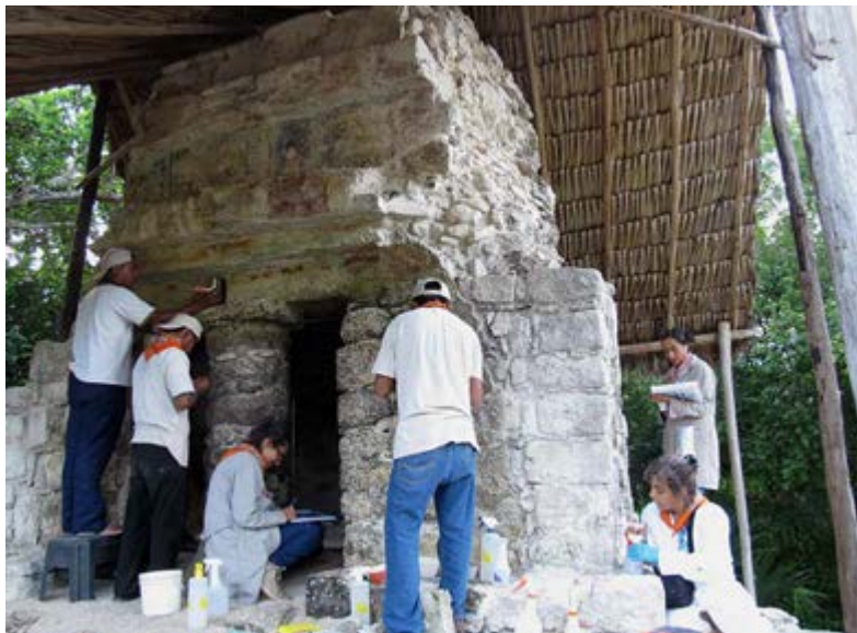
Figura 5. Durante los trabajos de conservación en la Estructura 1, Grupo Pinturas de Cobá, mediante proceso. Imagen: Mónica A. López Portillo Guzmán, 2016, ©CNCPC-INAH.
