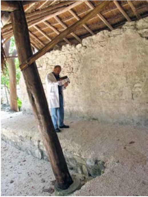
Figura 8. El arquitecto Héctor Henández, durante el diagnóstico del precario estado de condición de la palapa de la Estructura 8 de El Meco. Imagen: Mónica A. López Portillo Guzmán, 2016, ©CNCPC-INAH.
