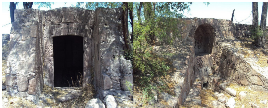
Fotos 2 y 3. Compuerta central y este. En ambas podemos apreciar en las áreas marcadas el contrafuerte tipo talud en las secciones laterales.
