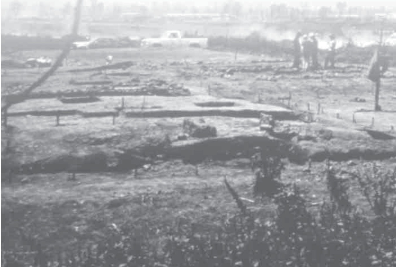
Excavaciones y obra de construcción en la Central de Abastos, D. F. © Archivo Dirección de Salvamento Arqueológico-INAH.
