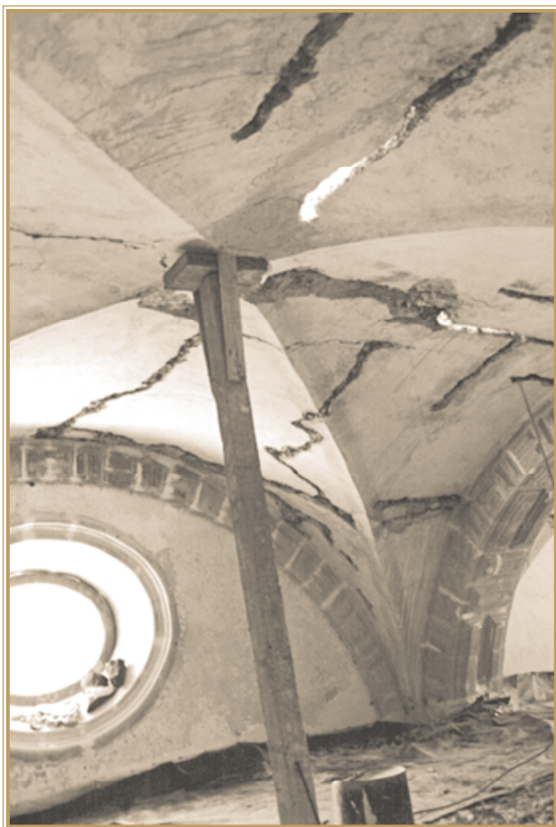
Norma Laguna Orduña. Proceso de consolidación de la estructura de la bóveda de la sacristía, Santa Prisca y San Sebastián, Taxco de Alarcón, Guerrero.
