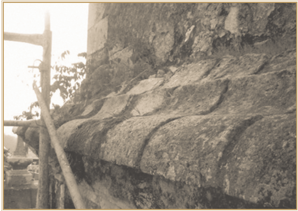
Issac Estrada. Crecimiento de vegetación, desplazamiento de sillares de cantera en las cornisas de cambio de espesor de muros en la nave principal, Santa Prisca y San Sebastián, Taxco de Alarcón, Guerrero.
