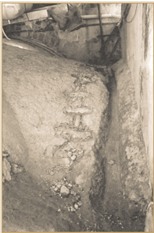
Norma Laguna Orduña. Consolidación de las fracturas de la bóveda con piezas de traslape con materiales similares, Santa Prisca y San Sebastián, Taxco de Alarcón, Guerrero.
