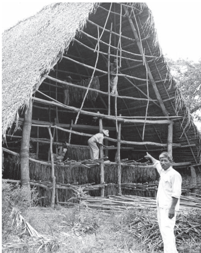
Fotografía 14 Edificando una casa en la región de Chiltepec Imagen Howard Brunson, ca. 1950, FW 2703
