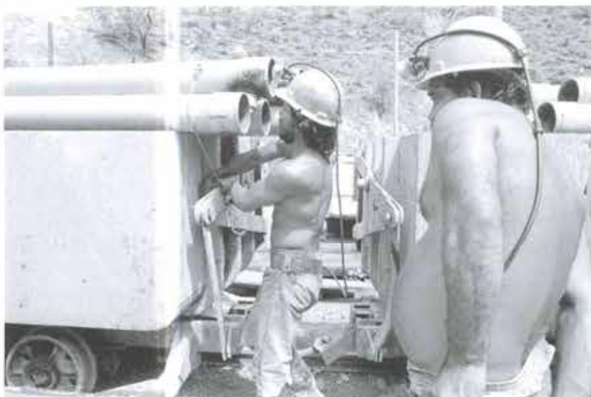
Tubos para bombeo, Tayoltita, Durango. Foto: David Maawad
