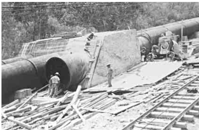
Block de anclaje. Planta Lerma, estado de Michoacán, 1949. Fototeca de Luz y Fuerza del Centro. Archivo Histórico.
