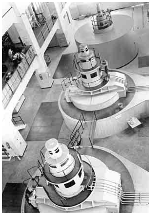
Unidad N° 3 lista para entrar en servicio. Planta Lerma, estado de Michoacán, 1953. Fototeca de Luz y Fuerza del Centro. Archivo Histórico.
