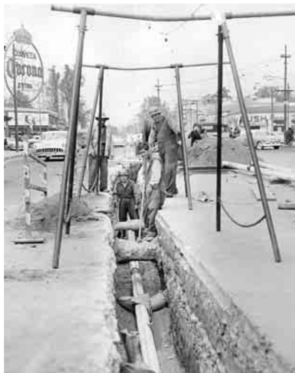
Personal de cables subterráneos, por los rumbos de Ermita. Ca., 1950. Fototeca de Luz y Fuerza del Centro. Archivo Histórico.
