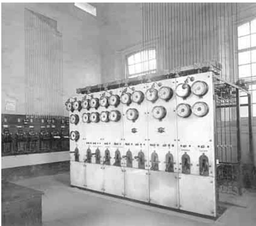
Equipo de baja tensión en la subestación Pachuca, Hidalgo, Ca., 1915. Fototeca de Luz y Fuerza del Centro. Archivo Histórico.
