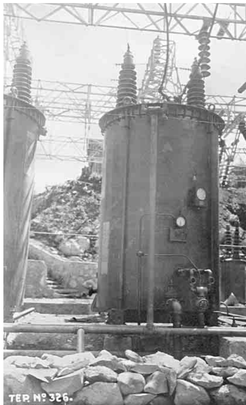
Detalle de un transformador montado en su base. Planta Tepexic, Puebla. Ca. 1922. Fototeca de Luz y Fuerza del Centro. Archivo Histórico.
