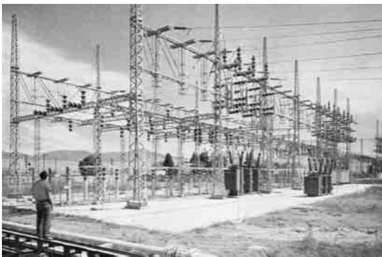
Subestación de la planta Lechería. Trabajos hechos en 1959. Archivo Histórico de Luz y Fuerza del Centro.
