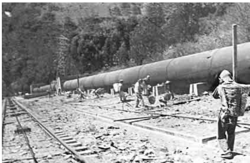
Excavación para los pilares de la tubería de presión. Planta Lerma, estado de Michoacán. 1949. Fototeca de Luz y Fuerza del Centro. Archivo Histórico.
