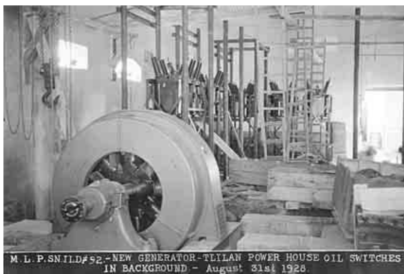
Interior de la casa de fuerza en Tlilan, 1928. Fototeca de Luz y Fuerza del Centro. Archivo Histórico.
