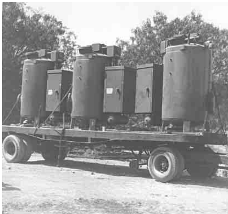
CABLE 85 KV. Mecanismos de los switches de aceite para la subestación San Lázaro, 1951. Fototeca de Luz y Fuerza del Centro. Archivo Histórico.
