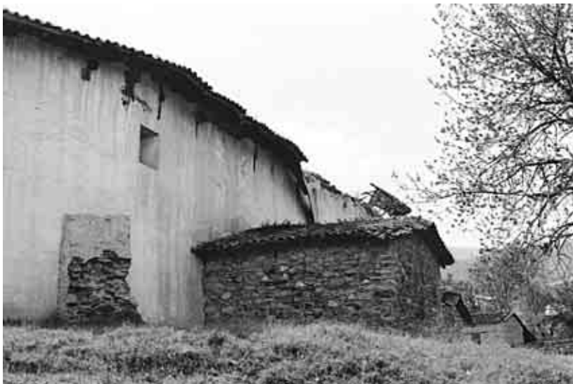
Adosamiento de fecha posterior al templo y contrafuertes destruidos.
