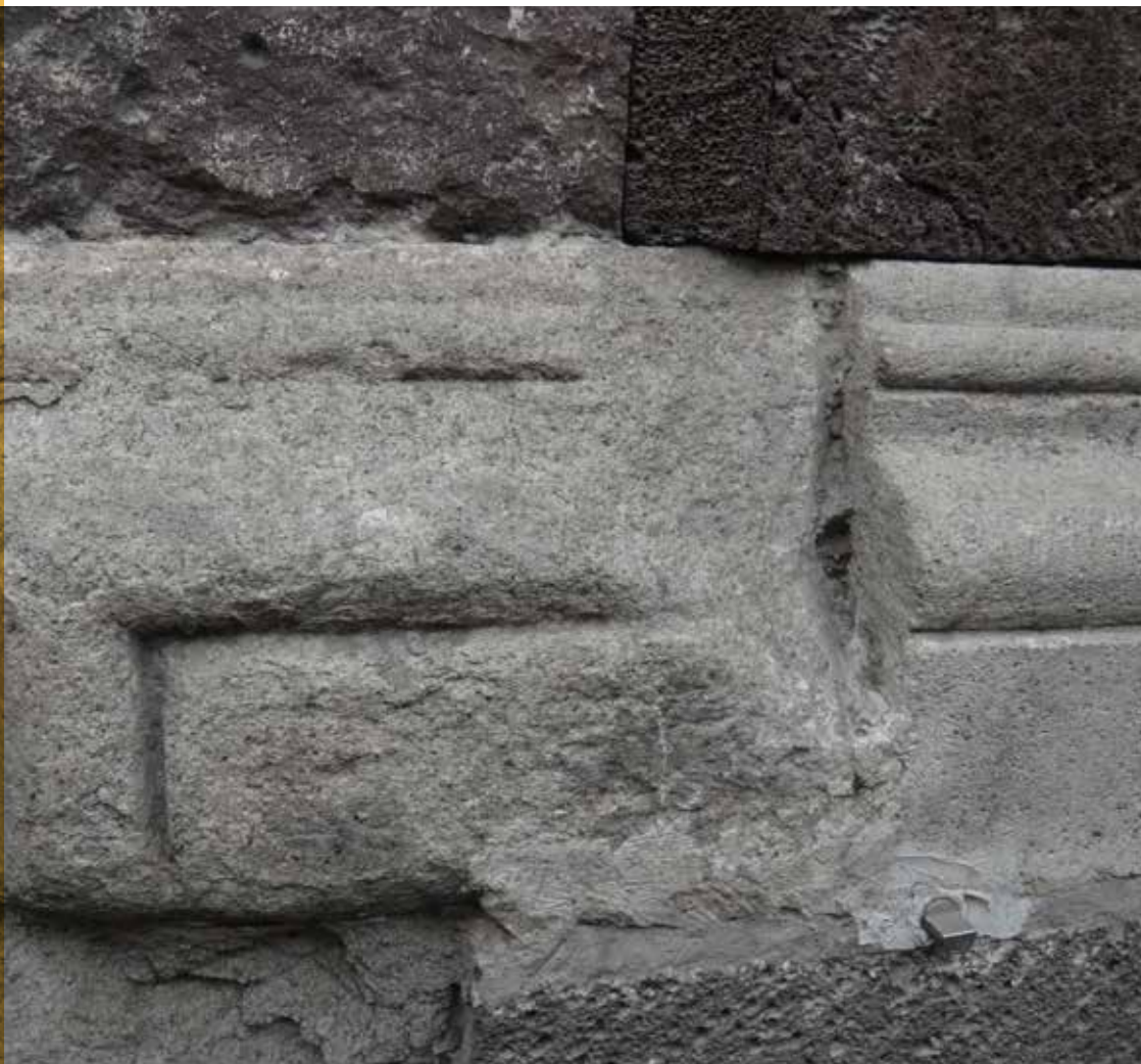
Figura 3. Piedra afectada por la presencia de sales provenientes del cemento. 2012. Sámano, M.
