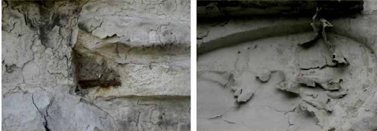
Figura 4. Detalles del deterioro ocasionado por la corrosión de las varillas y el desprendimiento de las capas de pintura vinílica.
