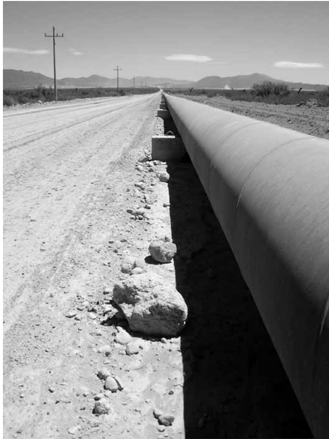
Fig. 6 Conducto de tubería para el transporte de las aguas de los pozos hasta la planta de procesamiento de los metales (foto Pánico).
