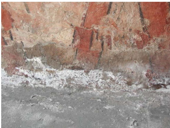
Eflorescencias salinas en uno de los Templos Rojos
