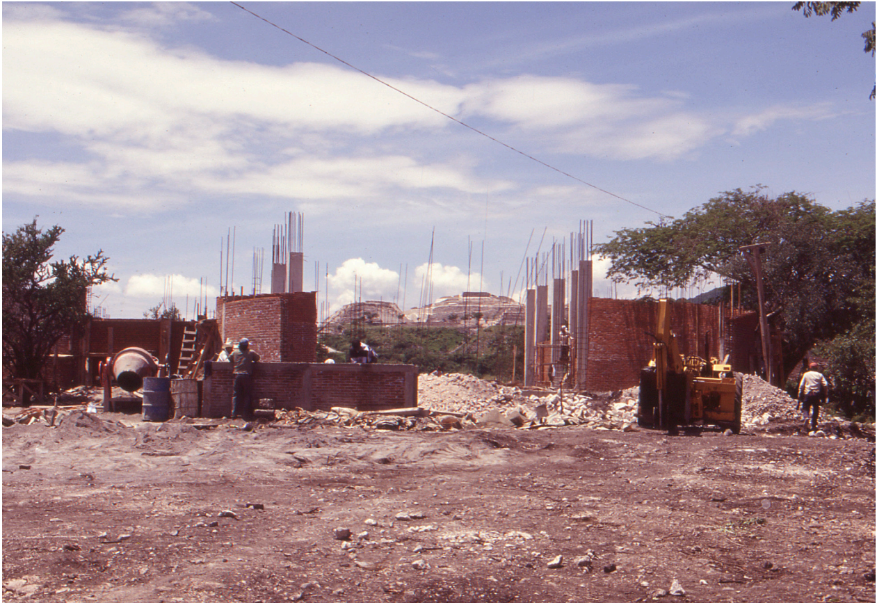
Inicio de trabajos de construcción del nuevo Museo de Sitio Xochicalco. 1993. Fondo: "Proyecto arqueológico Xochicalco 1984-2002" Colección: Silvia Garza Tarazona y Norberto González Crespo, Fototeca Juan Dubernard.
