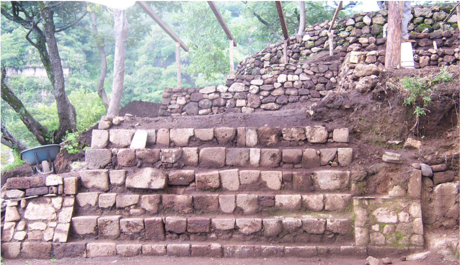
Estado de la fachada del templo principal de la cima de El Tlatoani, tras ser intervenido por agentes locales sin técnica arqueológica (Foto Guilebaldo Banderas 2009).
