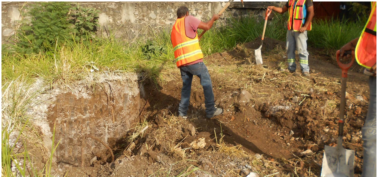
Aspecto general del proceso de excavación de la unidad arqueológica al interior del predio donde la empresa Pullman de Morelos promovió edificación de obra. (Foto Juana Mitzi Serrano Rivero 2022).
