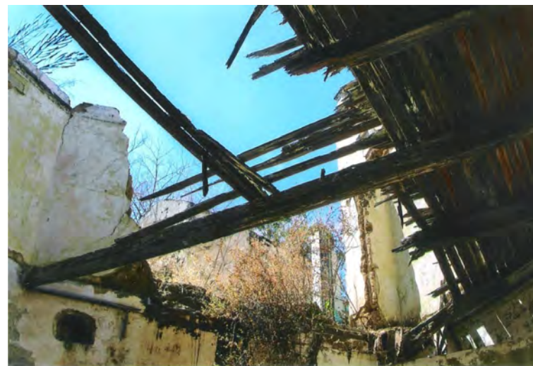
Figura 3. El entrepiso y la cubierta que corresponden a la torre, al igual que en todo el edificio, estaban colapsadas. Cedieron al paso del tiempo y las estructuras de cubiertas se perdieron, ocasionando los demás deterioros: deslave de cabezales de muros, pérdida de aplanados, crecimiento de flora, invasión de fauna nociva. El abandono es evidente.
