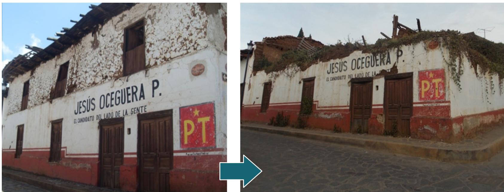
Figura 15. Monumento histórico que muestra deterioro progresivo. Fuente: Fotos tomadas por la autora [izquierda, 2011; derecha, 2013].
