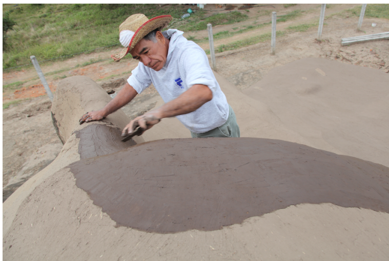
Figura 8. Aplicación del aplanado fino con emulsión asfáltica a la pirámide, Yuko Kita, 2013.
