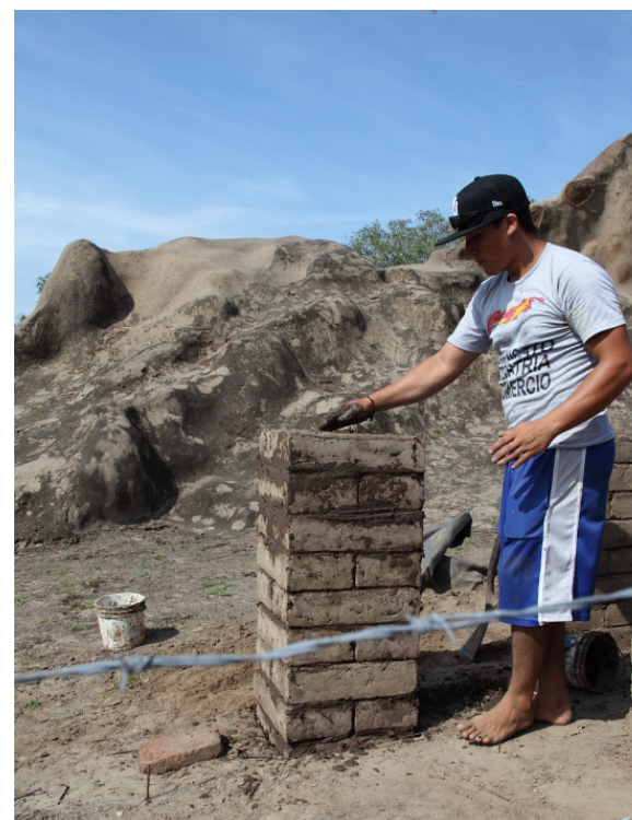
Figura 10. Muro de mampostería de adobe de la 2ª serie de prueba, Annick Daneels, 2013.
