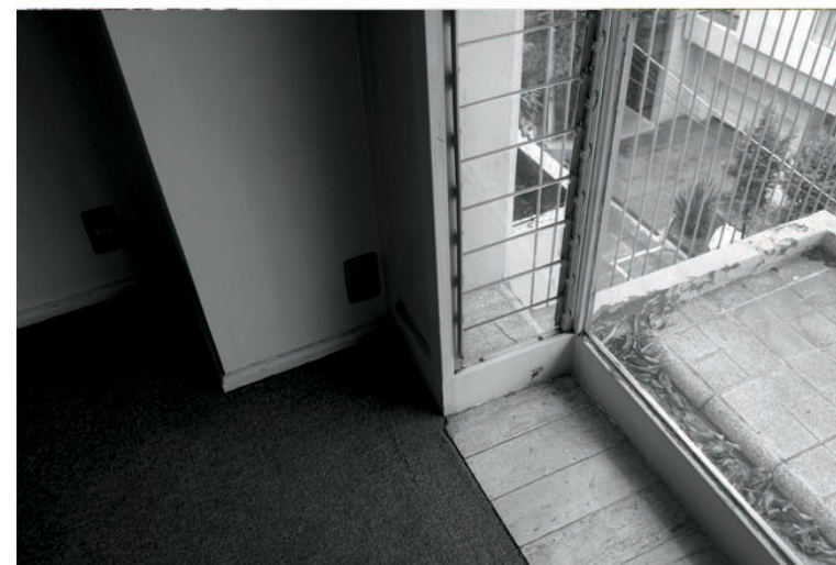
Figura 8. Edificio en Lope de Vega 333; arriba: detalle de llegada de muro, lambrin de espejo y plafón en vestibulo del edificio; abajo: detalle de llegada del cancel corredizo de fachada, ventilas laterales y remate de mármol para proteger la alfombra.
