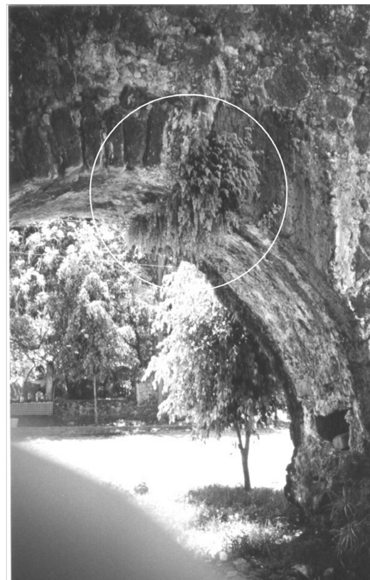
Figura 4. Grietas y humedades en la estructura de los arcos provocan pérdida de material pétreo y calidad de argamasas de cal.
