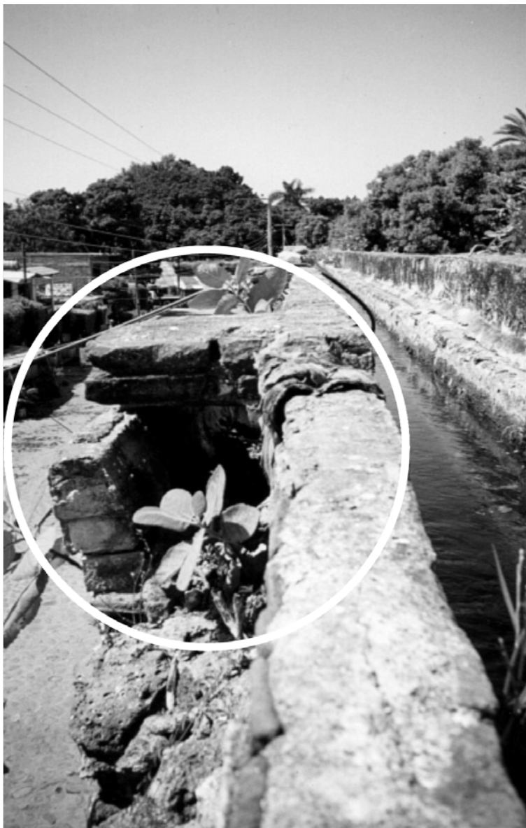
Figura 8. Fotografía que muestra los problemas en el canal del acueducto; se observa que en su momento condujo agua potable. MAC, 2014.
