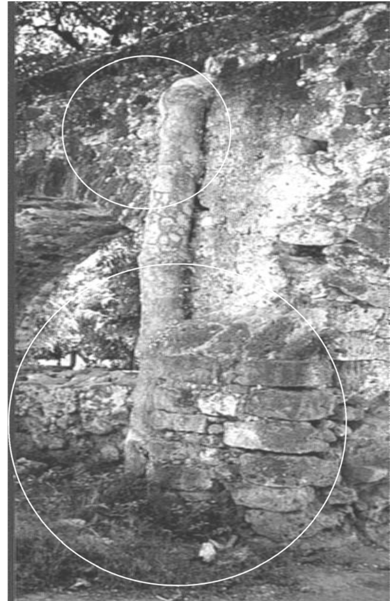
Figura 7. Fotografía que muestra los problemas en la conexión de tuberías en albañal. Alimentación a extensos jardines particulares. MAC, 2009.
