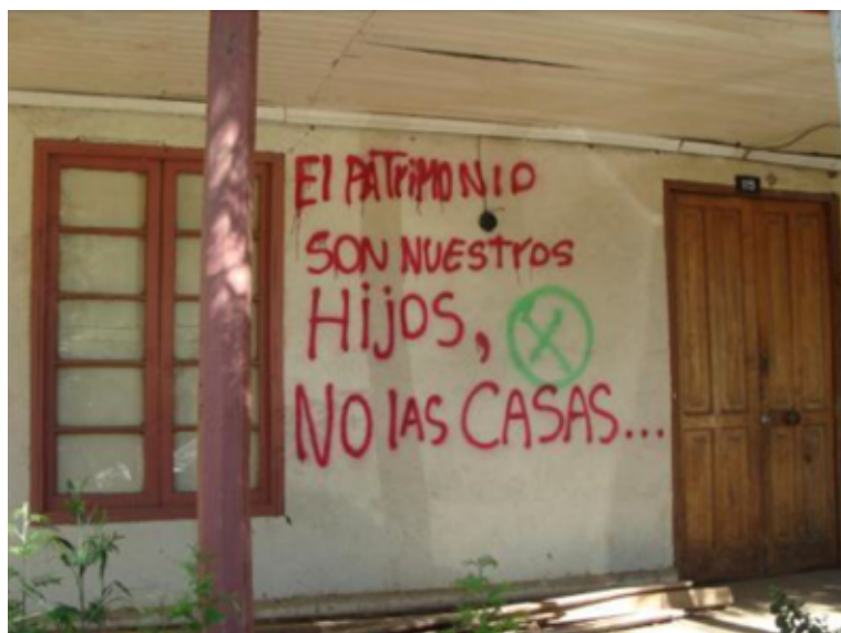
Figura 2. Inmueble afectado por el terremoto marcado con una cruz verde por los equipos de emergencia, y con mensaje escrito por los habitantes del poblado posteriormente (2010). Fuente: Consejo de Monumentos Nacionales (2010).
