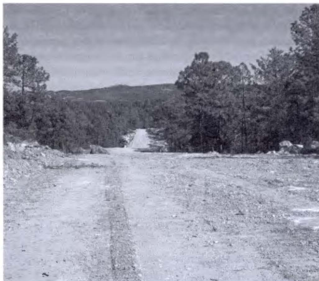
Imagen 19. La deforestación provocada por el paso del gasoducto. San Elías. Miriam Rodríguez. Diciembre de 2014.
