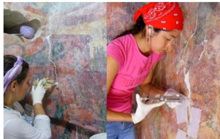
Figura 3. Tratamiento de consolidación en las grietas de los muros. (Fotografía: Constantino Armendáriz, 2009.)
