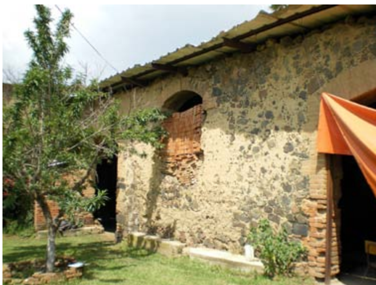
Fig. 5 Adecuación de espacios con elementos discordantes como lonas y vanos tapiados. Hacienda San José Foto: Mónica Márquez. 2009
