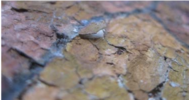
Fig.3 Detalle de escamación severa en superficie.
