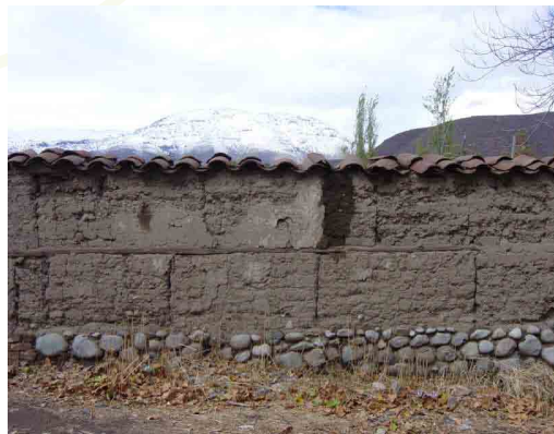
Fig.2. Tapiales agrietados por el uso de tierras arcillosas. Valle de Aconcagua, Chile.
