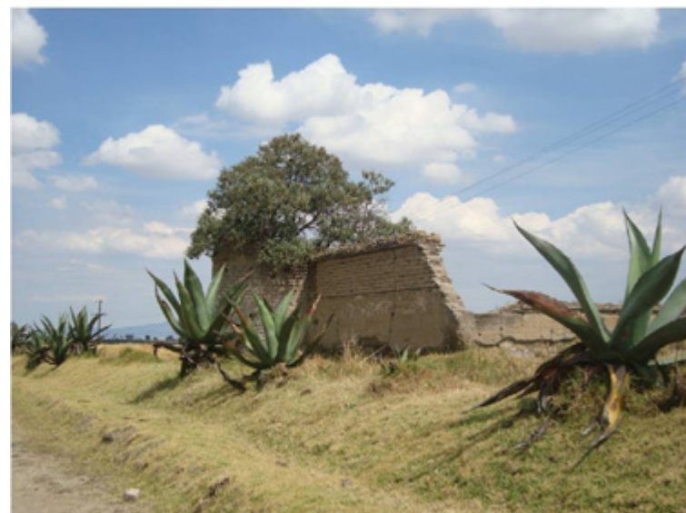
Figura 12. Estado de conservación de muros de tapia con adobe. Fotografía del autor
