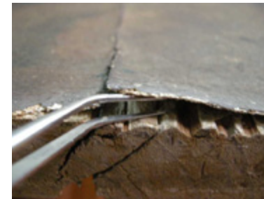
Figura 19. Desprendimiento de textil en el anverso
