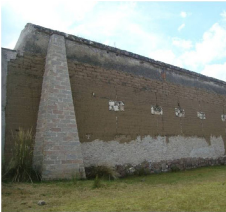
Figura 7. Muro de tapia en la fachada norte de la casa grande. Fotografía del autor
