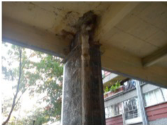
Figura 4. Detalle de elementos estructurales —columna, viga y losa— de planta baja dañados por la humedad provocada por fugas de agua en las tuberías de aguas negras ahogadas en la losa.
