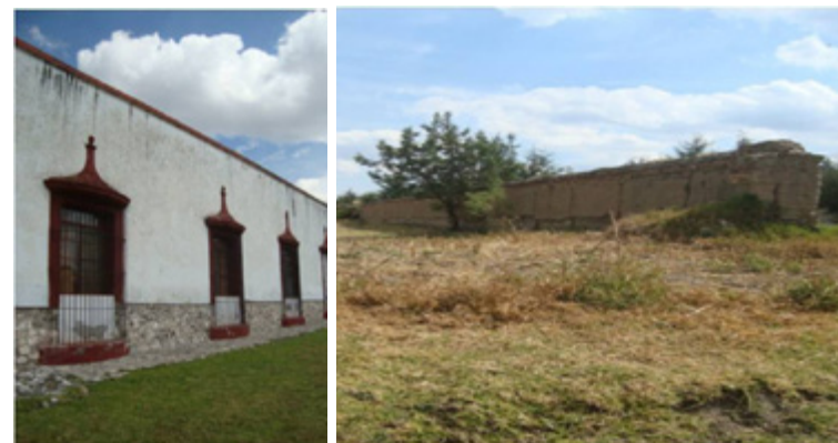
Figura 14. Distintos estados de conservación en muros de tapia de la hacienda de Santa Teresa Ixtafiyuca. Fotografías del autor
