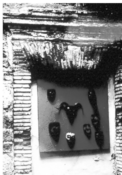
Ejemplos de humedad en muros y pisos Fotografías MITG
