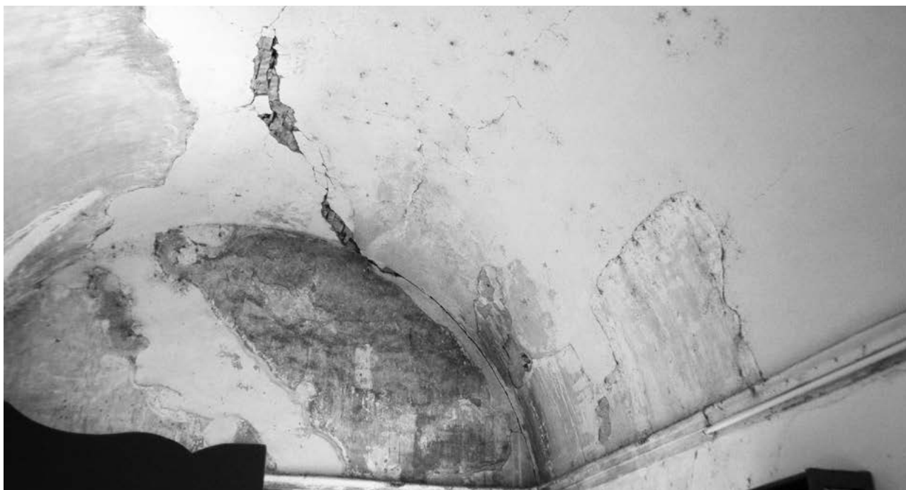
Interior de la bóveda, donde se observan los daños acumulados durante años Fotografía © Mariana López
