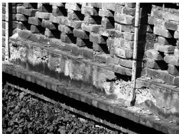
La falta de mantenimiento en elementos arquitectónicos específicos provoca otros daños en el inmueble Fotografía © Mariana López
