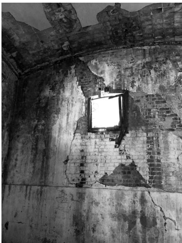
La falta de mantenimiento por años incrementa los deterioros Fotografía © Mariana López
