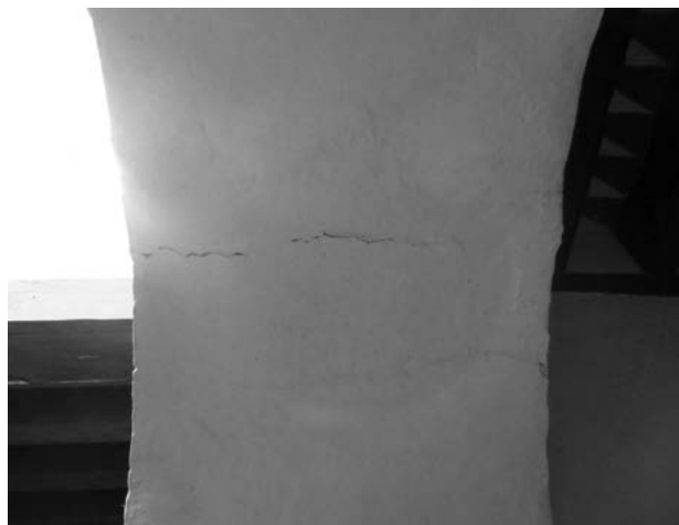
Arcos internos con presencia de fisuras Fotografía © Juan Manuel Dueñas Serrano
