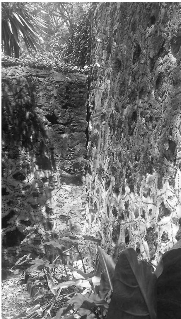
Barda desplomada Fotografía © Juan Manuel Dueñas Serrano
