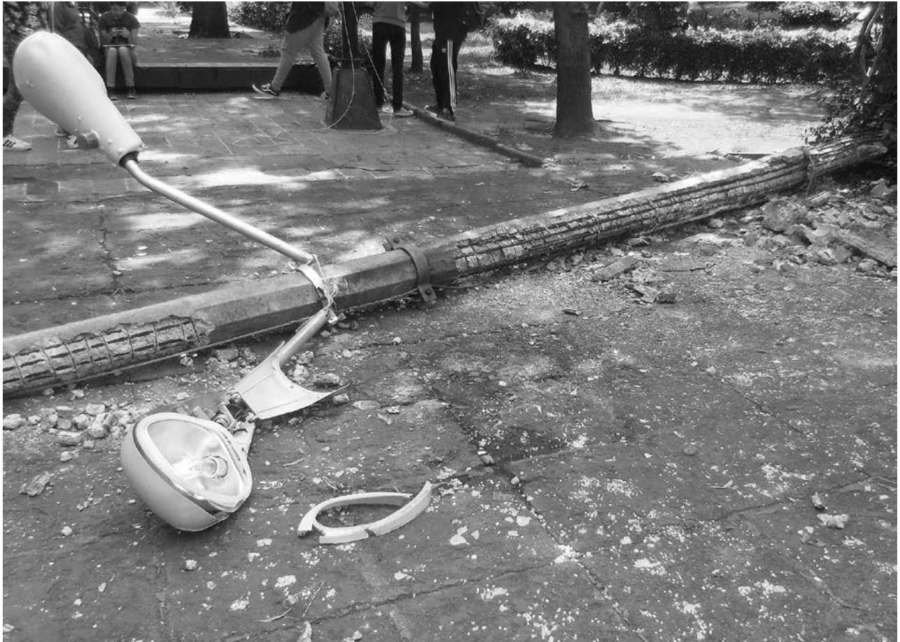
Poste y luminarias frente a la entrada al Museo Nacional de las Intervenciones Fotografía © Juan Manuel Dueñas Serrano
