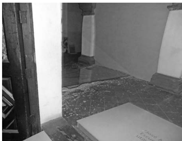
Vidrios caídos en montaje museográfico Fotografía © Juan Manuel Dueñas Serrano
