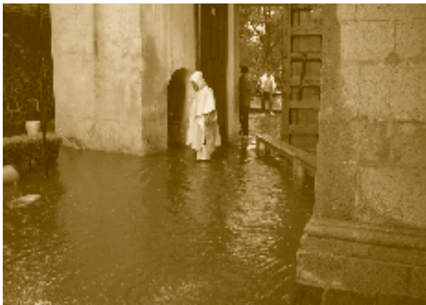
Mal funcionamiento del drenaje
