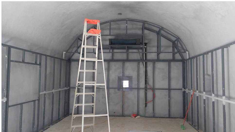
Colocación de una estructura para la recreación de la sala 2 y evitar daños en el edificio.
