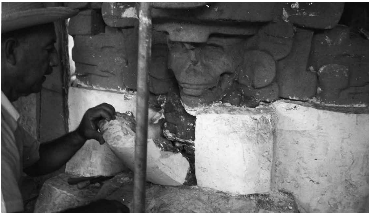
► Fig. 14 Remoción de la tercera franja de yeso. ZAPOTAL_ID_3_VERACRUZ. LII-20-2-3. Alicia Islas. Fototeca CNCPC |© INAH, 1974.
