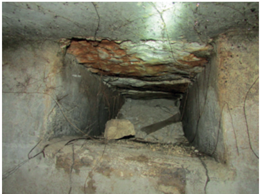
FIGURA 4. Ducto colapsado (Fotografía: Jorge Lara, 2017; cortesía: Universidad Modelo/Proyecto San Juan, 2017).
