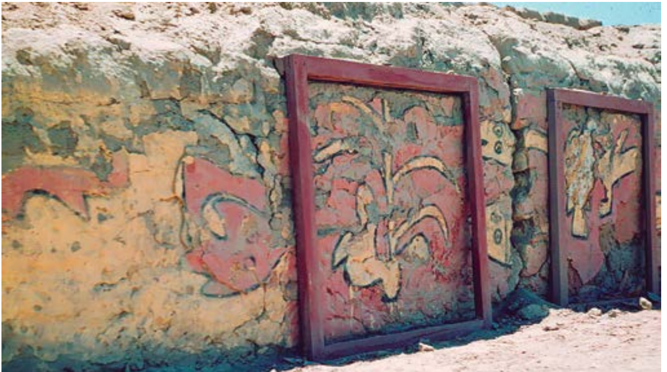
FIGURAS 10 y 11. Situación de las mamparas de vidrio deterioradas en 1940, según imágenes de los archivos de Paul Hanna (Fuente: Pozzi-Escot et al. 2013: 27).
