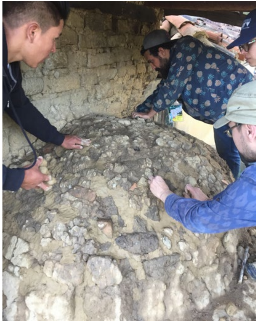
FIGURA 11. Restauración de un horno patrimonial durante un curso-taller para conservadores de la Escuela Taller de Boyacá, en Villa de Leyva, Colombia (Fotografía: Luis Fernando Guerrero Baca, 2018).
