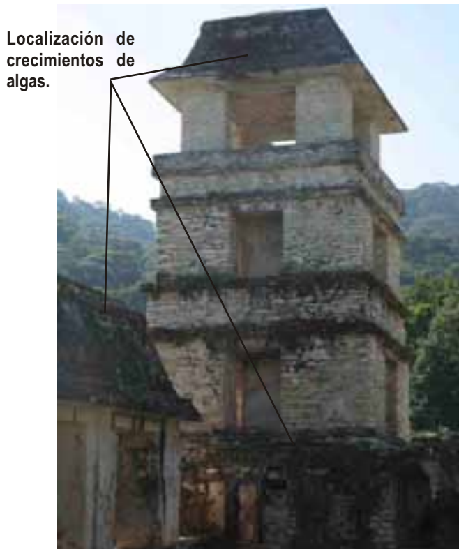
Figura 1. Depósitos de algas ubicadas en la Torre del Palacio.
