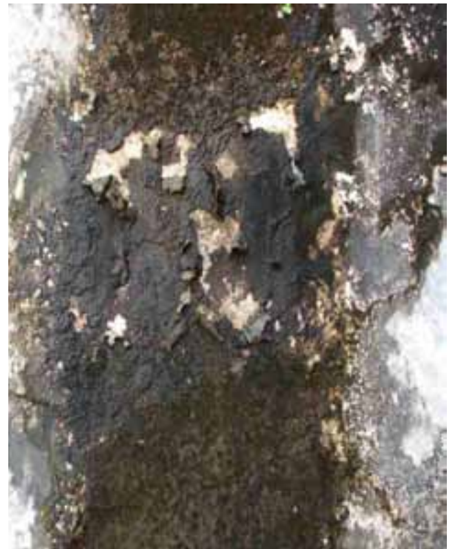
Figura 5. Crecimiento de Scytonema guyanense sobre un muro.
