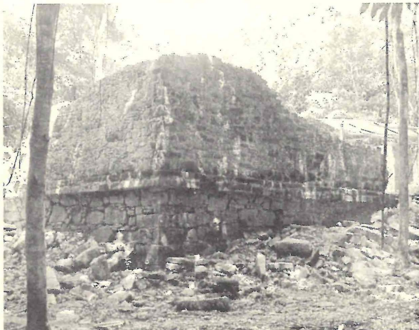
Aspecto del Templo XXI, en su ángulo suroeste, al inicio de los trabajos del PAP. El edificio destaca por su calidad constructiva de sus paramentos, erigidos con grandes y bien cortados bloques de piedra caliza.
