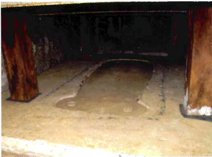
Foto 4. Soportes de madera en los extremos de los rieles
