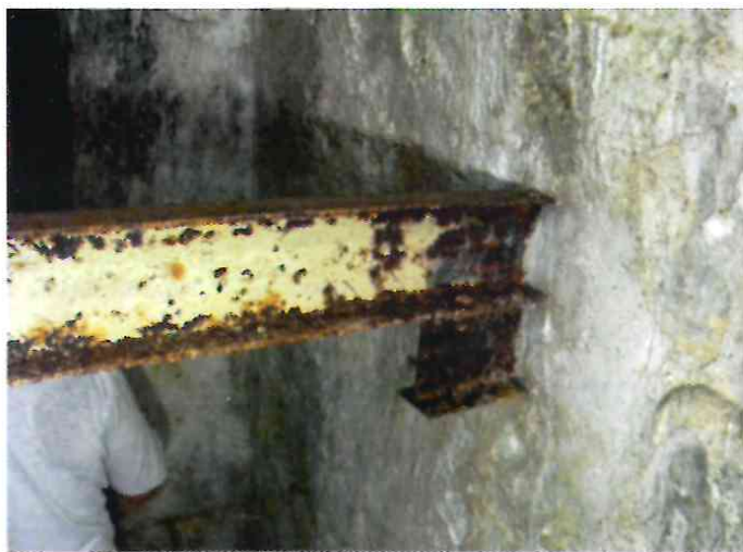
Foto 5. Vigas de hierro con avanzado estado de oxidación
