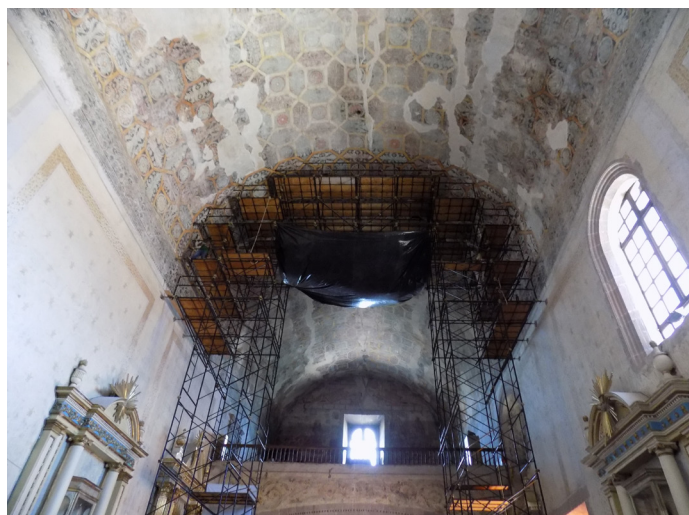
Bóveda del templo de Actopan, antes de la intervención de restauración. Fotografía: Gabriel Rivera
