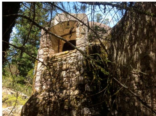
Sobre el trayecto del acueducto se localizan estas cajas de agua, para redireccionar y amortiguar la corriente acuifera. Fotografía: José Vergara Vergara
