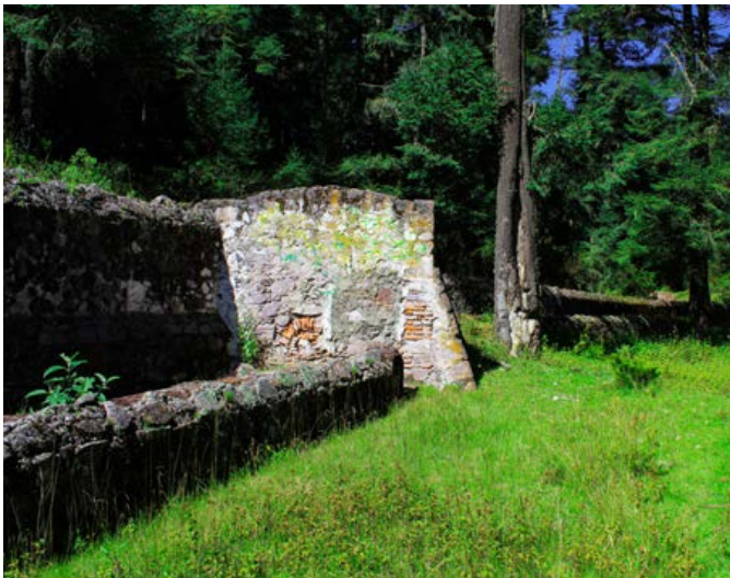
Caja protectora y recolectora de las aguas de los manantiales ubicados de la zona boscosa de la Sierra de Pachuca. Fotografía: José Vergara Vergara
