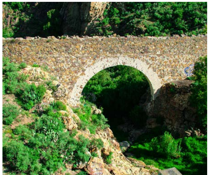
El Arco de San Juan, ubicado en la barranca de Texinca. Fotografía: José Vergara Vergara
