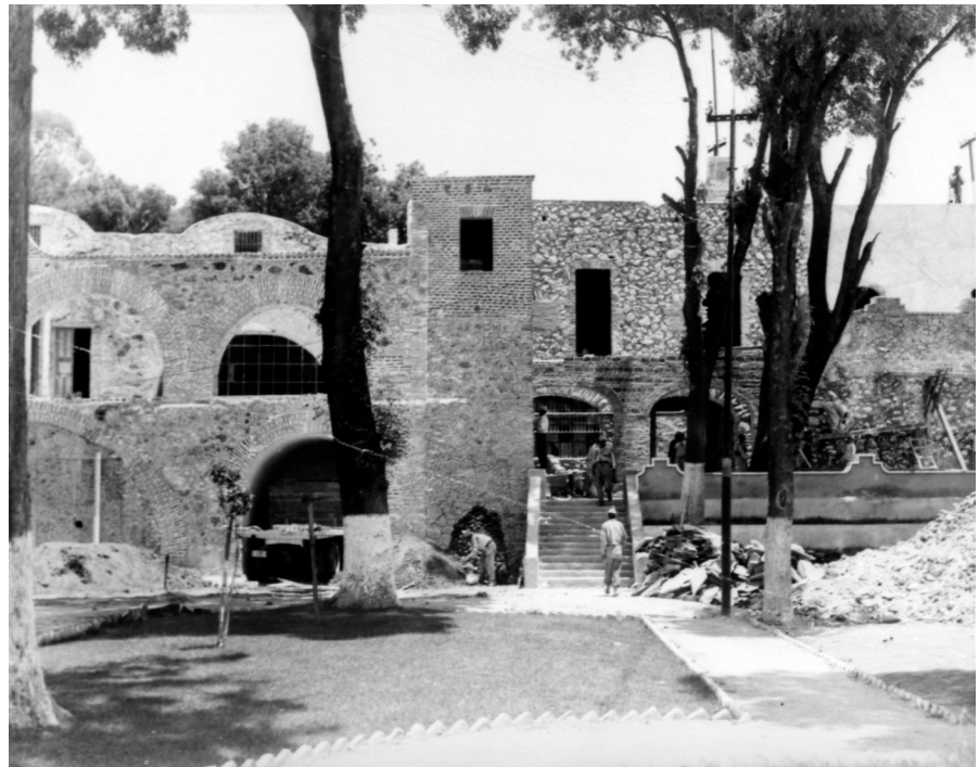
Trabajos de reconstrucción del área ocupada entre 1861 y 1936 por el Hospital Municipal y posteriormente por el Hospital Civil de Pachuca; ca. 1956. Fotografía: INAH. SINAFO.FN.MX. Cat. 298647
