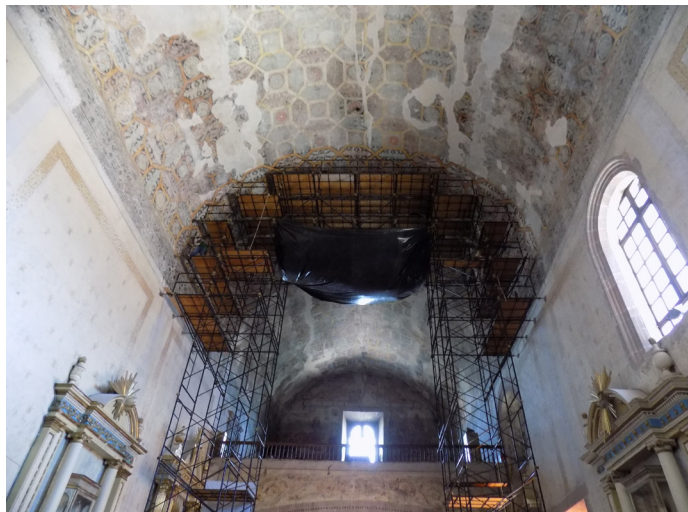
Bóveda del templo de Actopan, antes de la intervención de restauración. Fotografía: Gabriel Rivera
