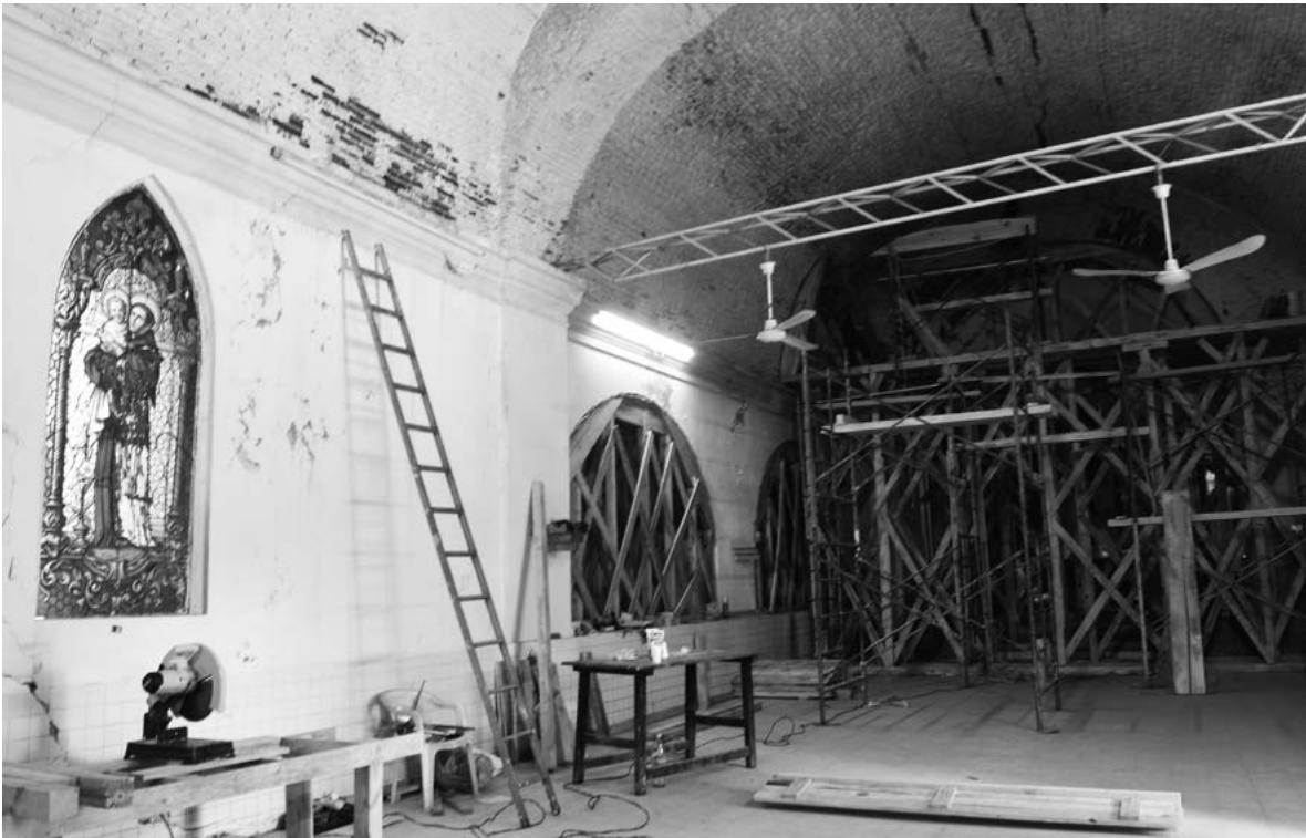
Iglesia apuntalada. Fotografía © Paola García.
