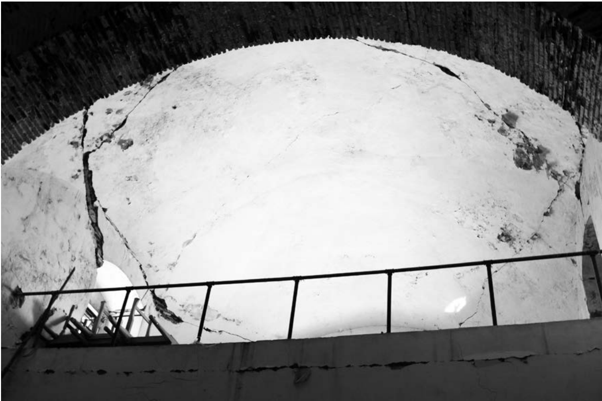
Grietas en una cúpula. Fotografía © Paola García.
