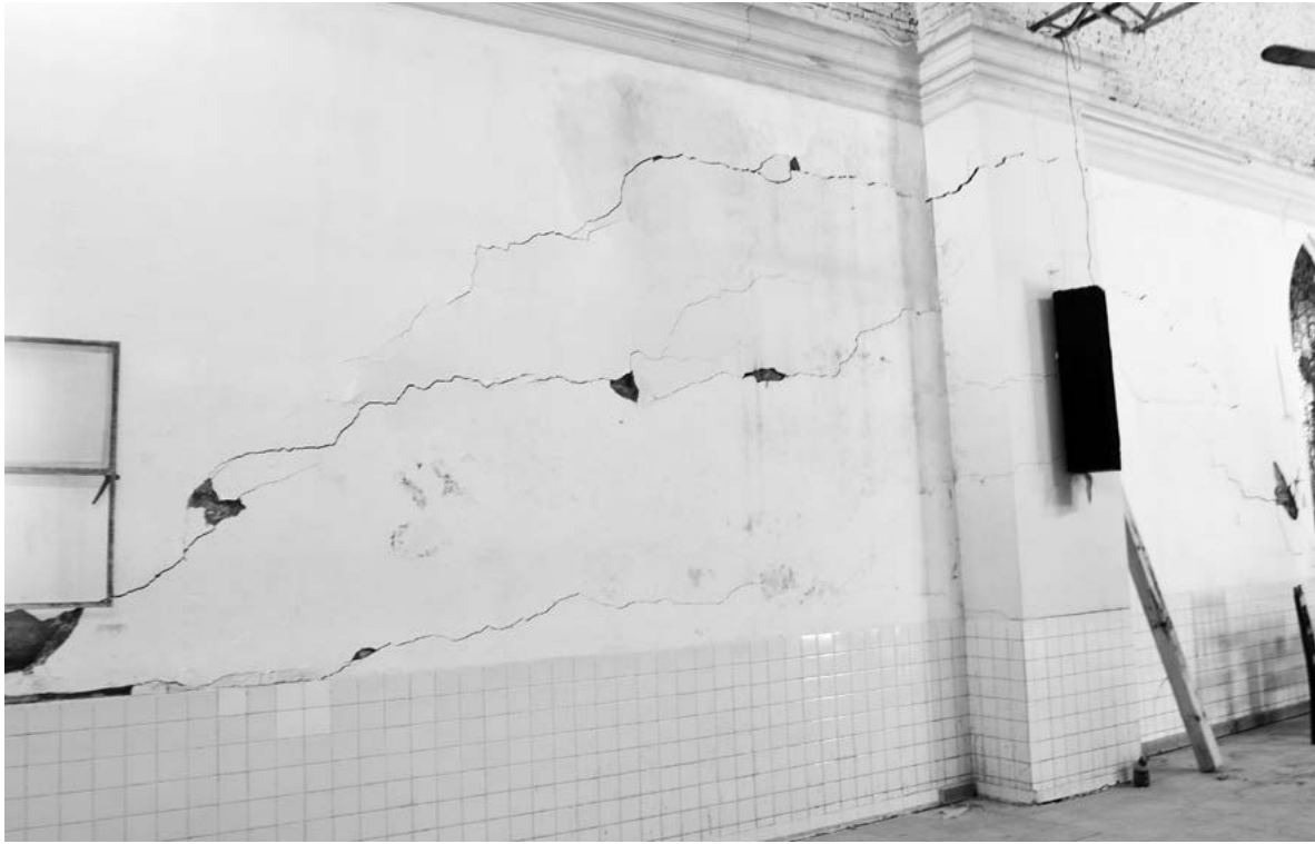
Grietas en una iglesia. Fotografía © Paola García.
