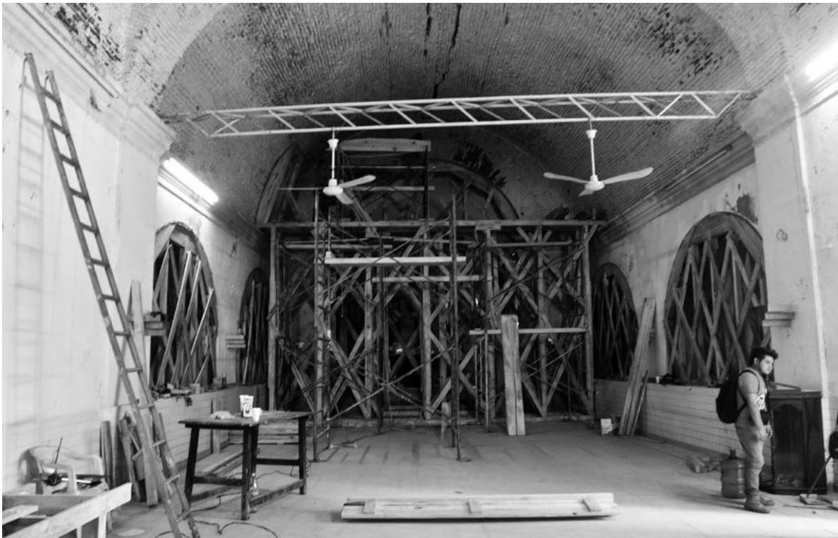
Iglesia apuntalada. Fotografía © Paola García.
