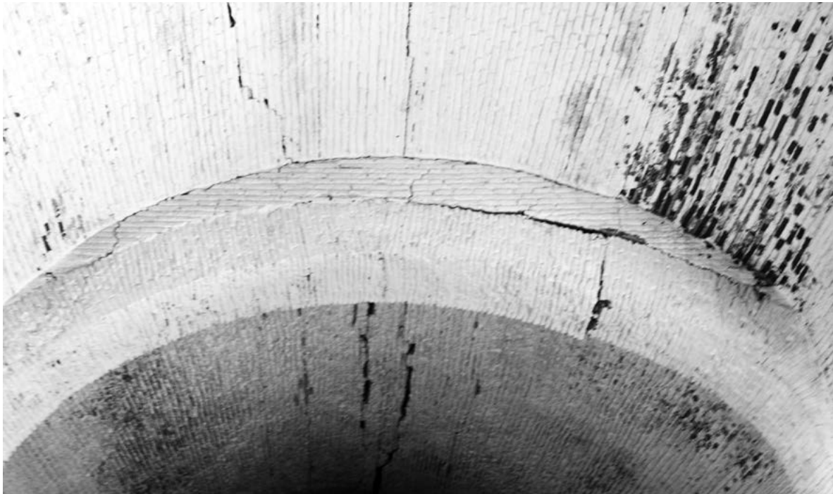
Grietas en un arco. Fotografía © Paola García.
