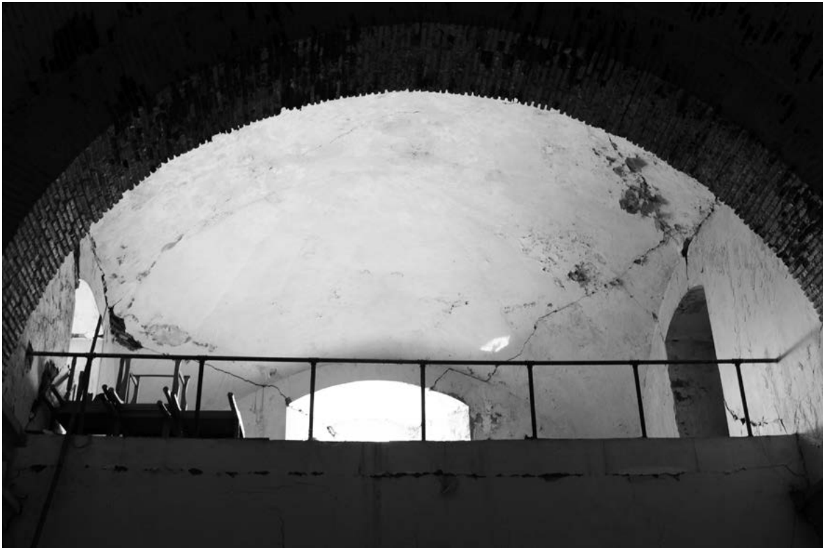
Grietas en una cúpula. Fotografía © Paola García.
