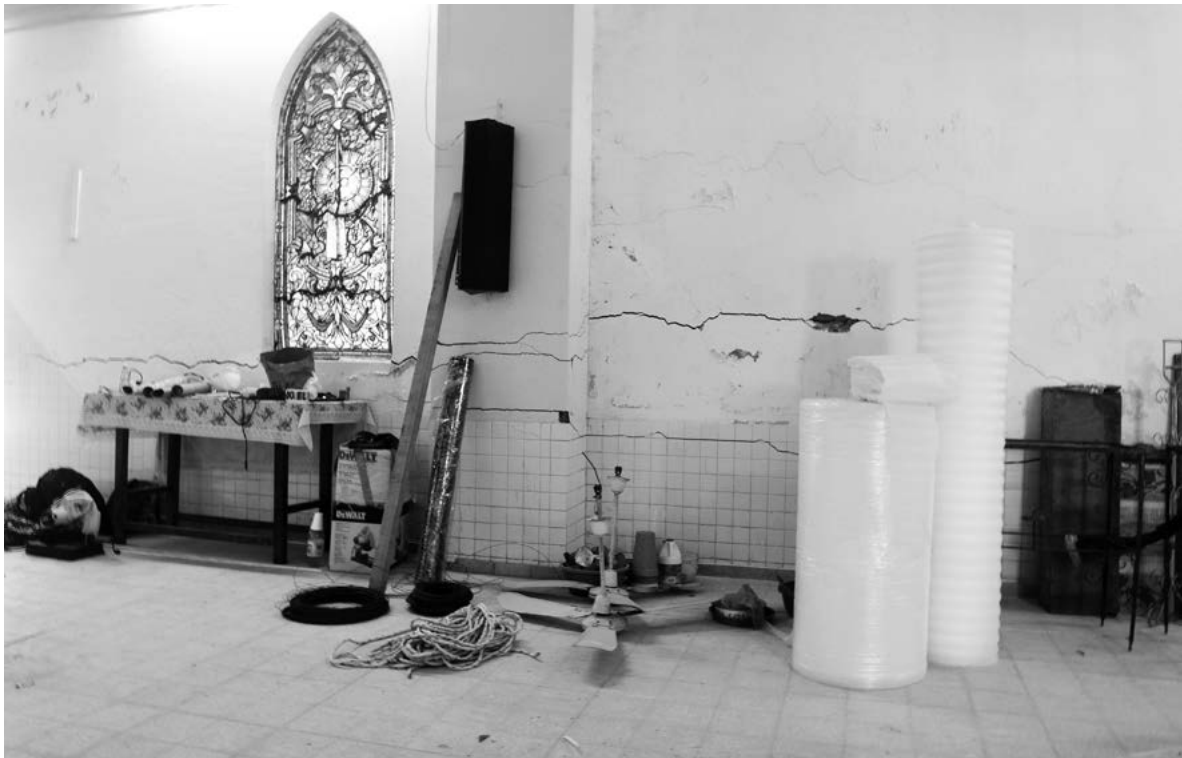
Grietas en una iglesia. Fotografía © Paola García.
