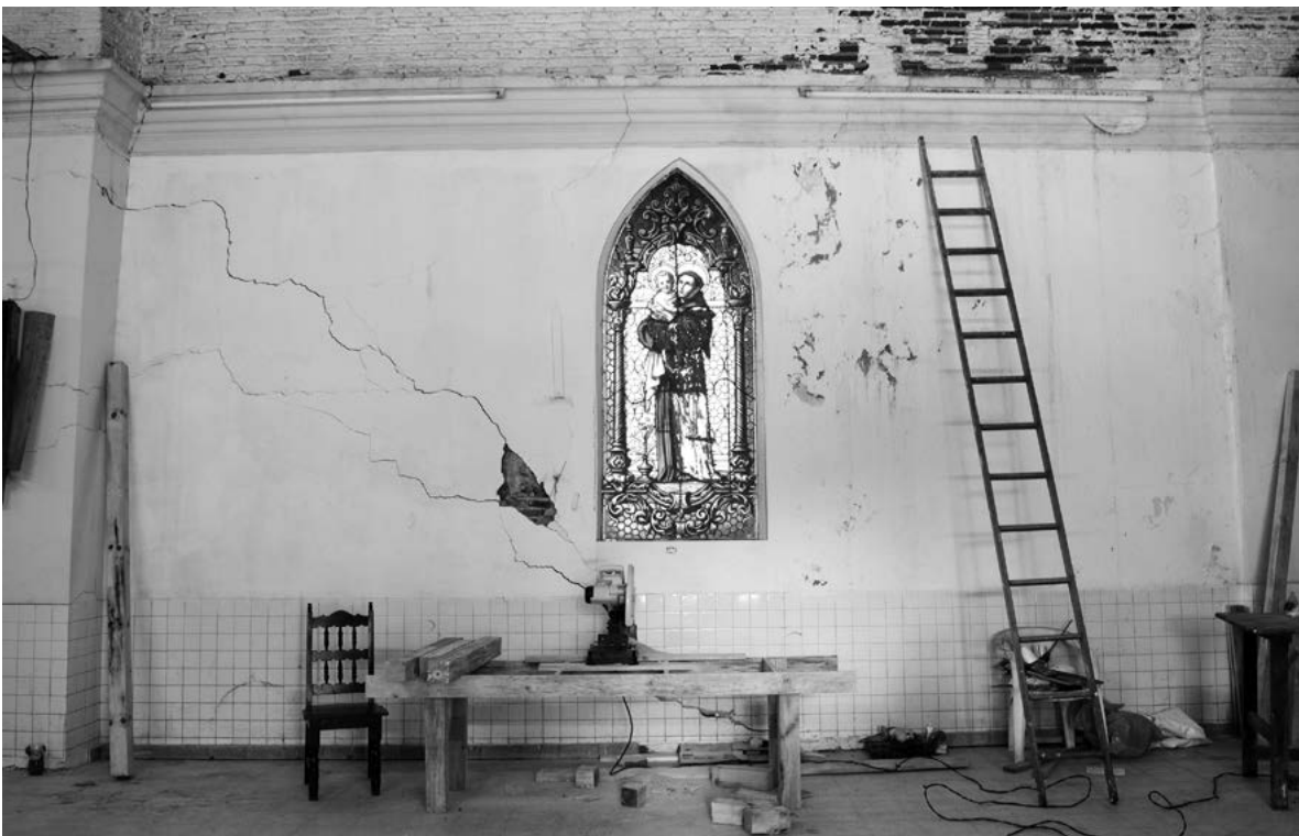
Grietas en una iglesia. Fotografía © Paola García.
