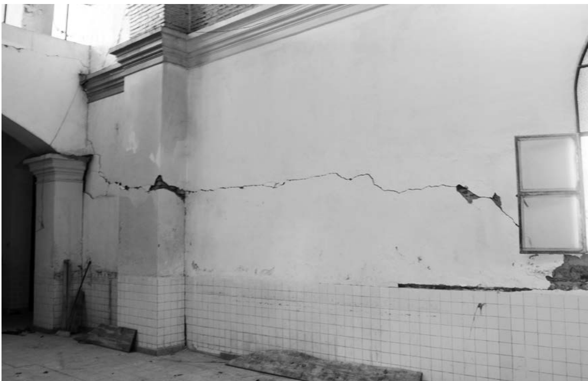
Grietas en una iglesia. Fotografía © Paola García.
