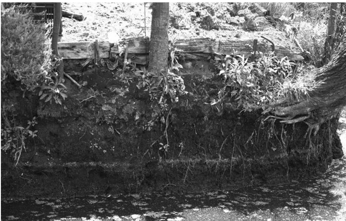
Figura 7. Marcas de pérdida de nivel de agua en canal. Paraje Tecaltitla, pueblo de San Gregorio Atlapulco, después del 19 de septiembre de 2017 y de los sismos del 16 y 19 de febrero de 2018. Fotografía © Leonardo Vega Flores, 19 de febrero de 2018.
