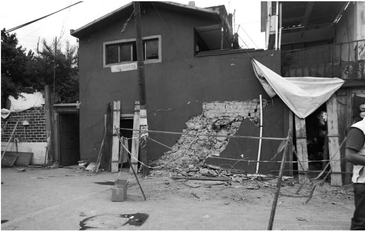
Figura 10. Una de las numerosas viviendas dañadas por el sismo en el pueblo de San Gregorio Atlapulco. Fotografía © Leonardo Vega Flores, 24 de septiembre 2017.
