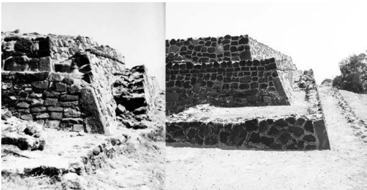
Figuras 7 y 8. A la izquierda, detalle de los muros originales del costado sur del monumento. A la derecha, esquina suroeste y muros consolidados del monumento. Fotografías © Raúl Arana.
