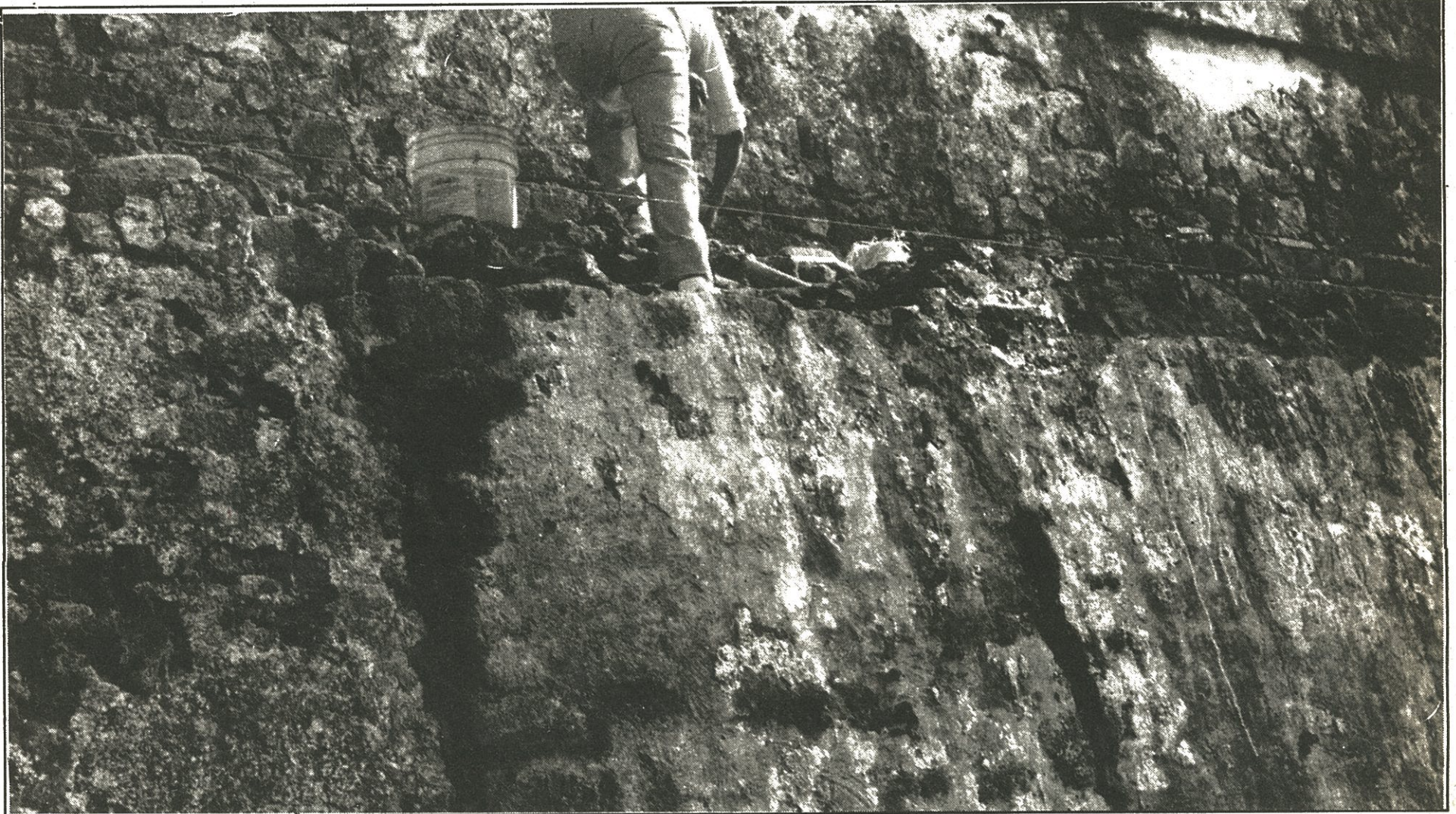
SE OBSERVAN claramente dos grietas del muro norte del primer cuerpo de la plataforma que ya han sido resanadas, así como el trabajo de restitución de piedras faltantes que está haciendo en esa momento don Rubén.
