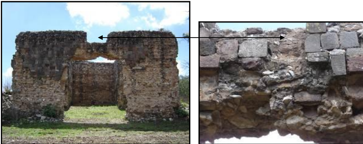
Figura 14. Vista general de la fachada principal, y detalle del deterioro ocasionado en el cerramiento horizontal a causa de la pérdida de materiales constructivos.
