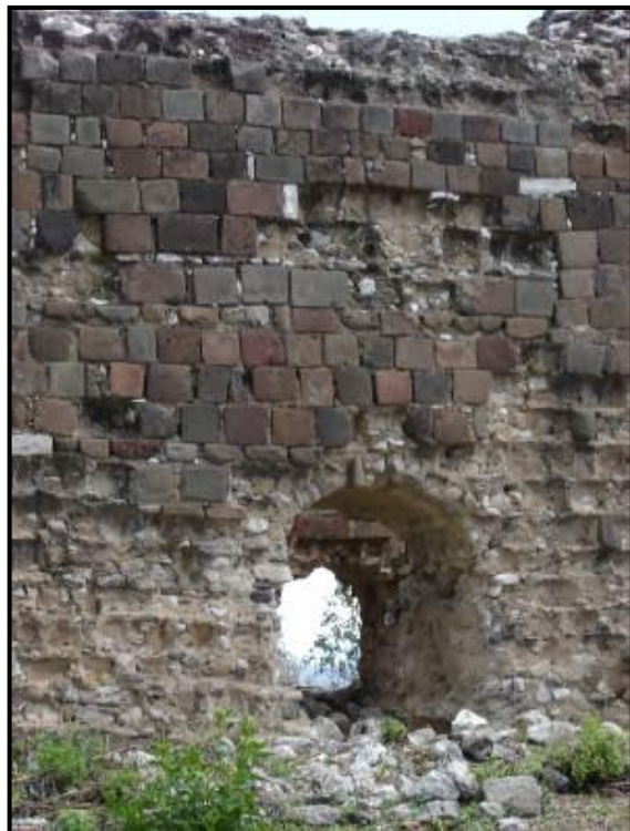
Figura 10. Detalle de la fachada exterior del muro Sureste, en él se puede apreciar los materiales y sistema constructivo que se emplearon en la manufactura de la iglesia del Siglo XVI.
