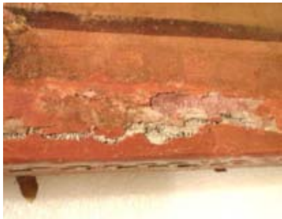
Figura 3. Detalle de craqueladuras y roturas.
