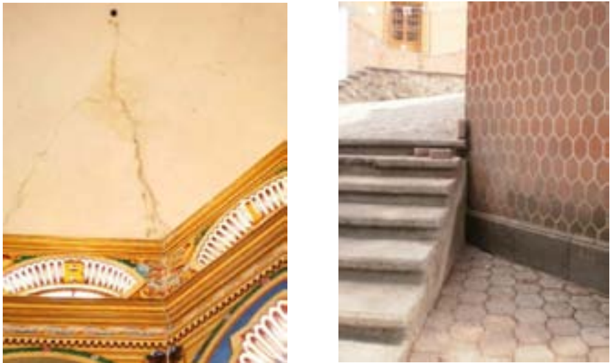
Figura 5. Grietas y fisuras en muro y cúpula, presencia de humedad.
