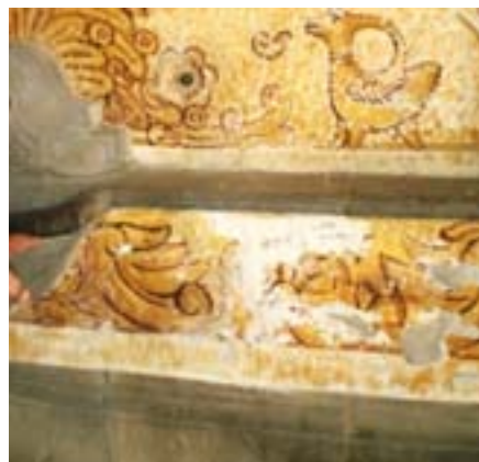
Figura 2. Deterioro por pérdida de pintura.
