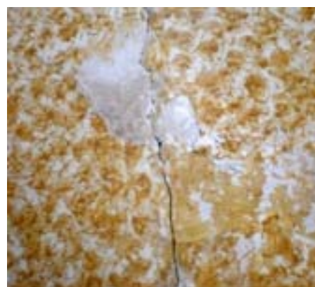
Figura 4. Deterioros; grietas y fisuras en la estructura de muro, así como pérdida de capa pictórica y escamas.
