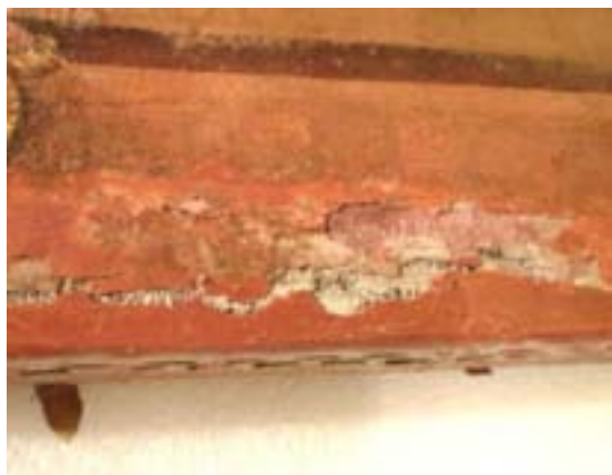
Figura 3. Detalle de craqueladuras y roturas.
