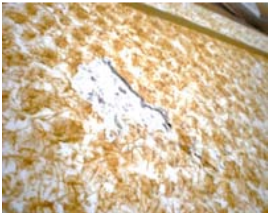
Figura 3. Deterioro por descamación, pérdida de base de preparación y capa pictórica, causados por la humedad
